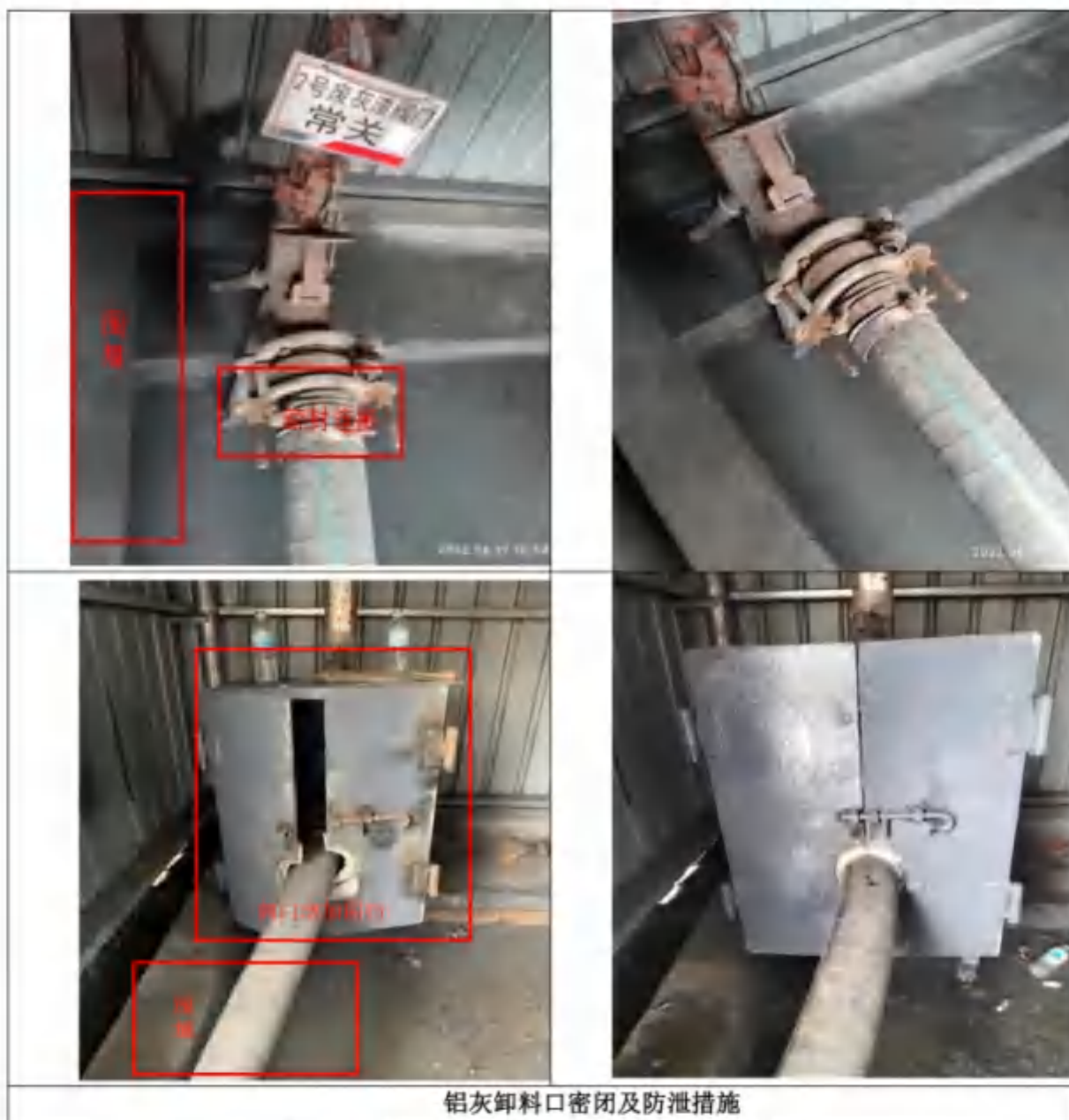
图 6.8.1-1 现有项目主要风险防范设施现场照片
