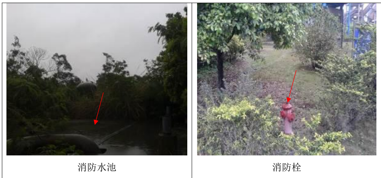
图 5-2 消防水罐及消防栓图
